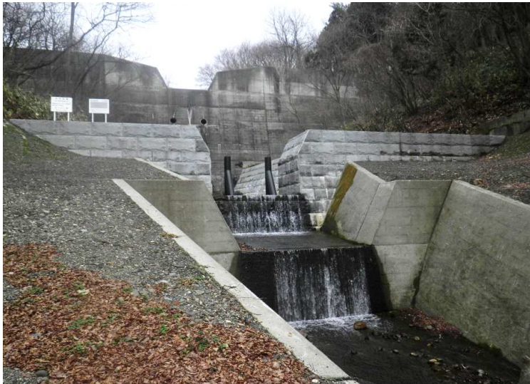
■岩木川圏域北大間沢総合流域防災砂防工事_深浦町 完成検査：令和4年12月27日
