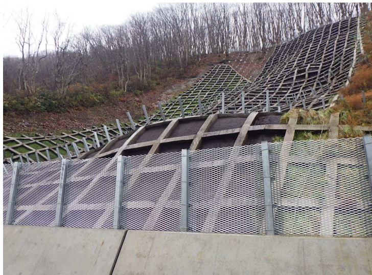
■ 川部区域急傾斜地崩壊対策工事_青森市 完成検査：令和4年12月23日
