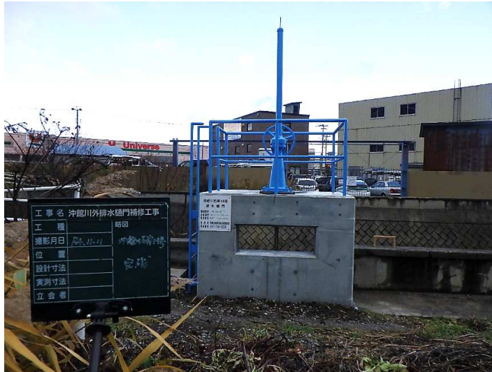
■ 沖館川外排水樋門補修工事_青森市 完成検査：令和4年11月29日
