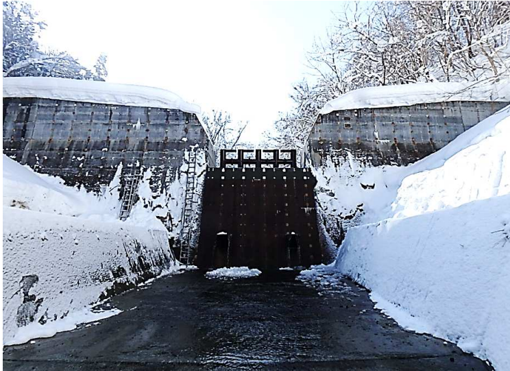
■小国沢第1号大規模特定通常砂防工事_平川市 完成検査：令和5年3月7日
