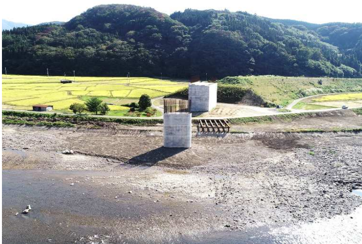
■国道101号道路改良(新追良瀬橋・P2)工事_深浦町 完成検査：令和4年10月14日
