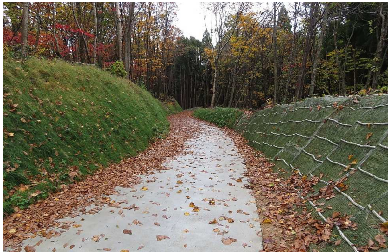
■令和3年度県営林業専用道西田浜名線開設工事_今別町 完成検査：令和5年2月10日
