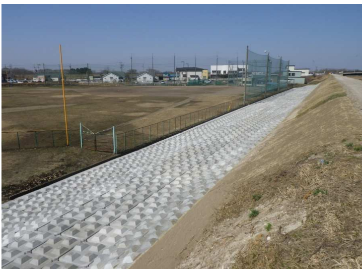
■十川総合流域防災(加速化対策)工事_五所川原市 完成検査：令和5年3月28日
