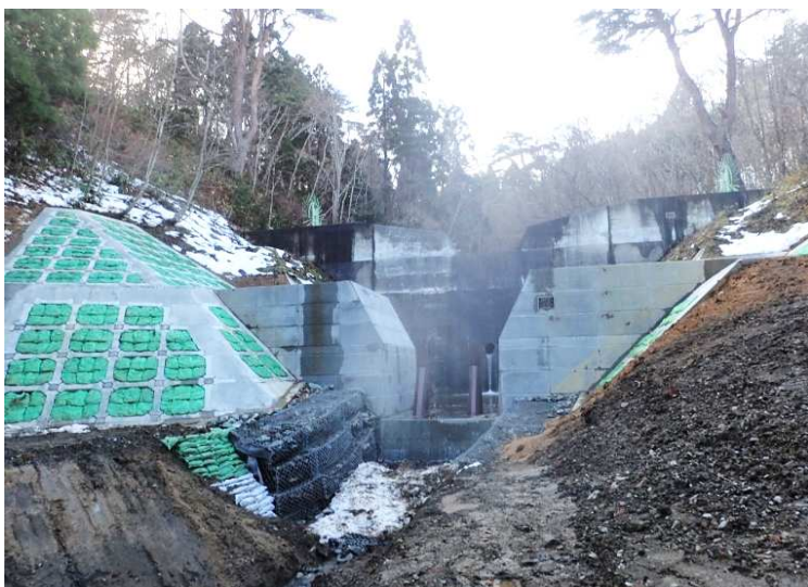
■北泊沢総合流域防災砂防工事_六ヶ所村 完成検査：令和5年1月20日
