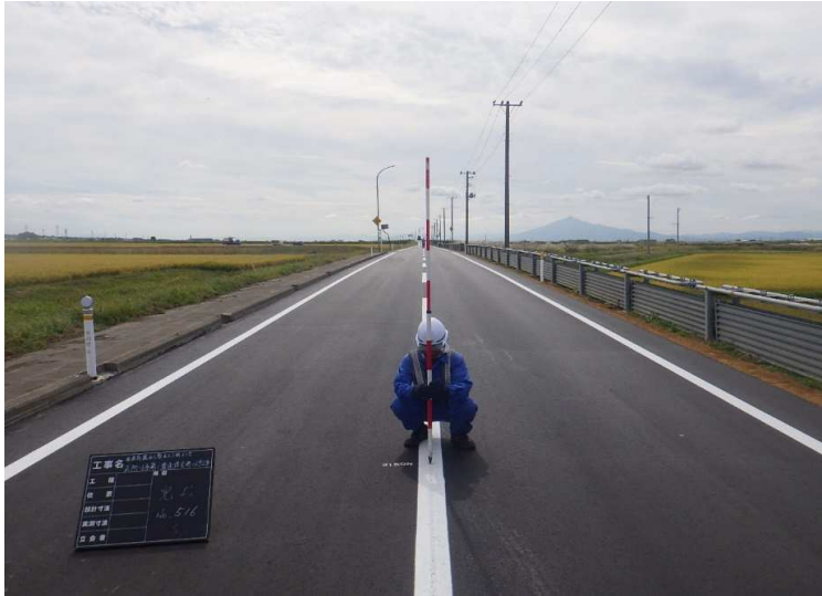
■五所川原第二農道保全第16号工事_中泊町 完成検査：令和4年9月30日
