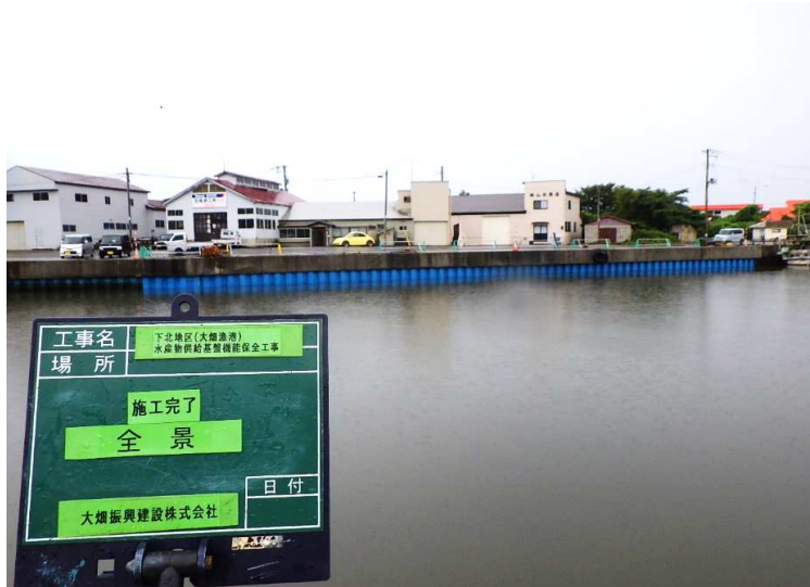
■ 下北地区(大畑漁港)水産物供給基盤機能保全工事_むつ市 完成検査：令和4年9月29日
