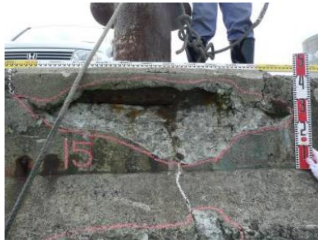
コンクリート剥離（青森港本港地区-7.5m岸壁）
