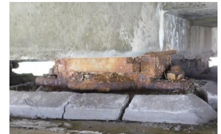
橋梁支承の劣化(青森港埠頭大橋)
