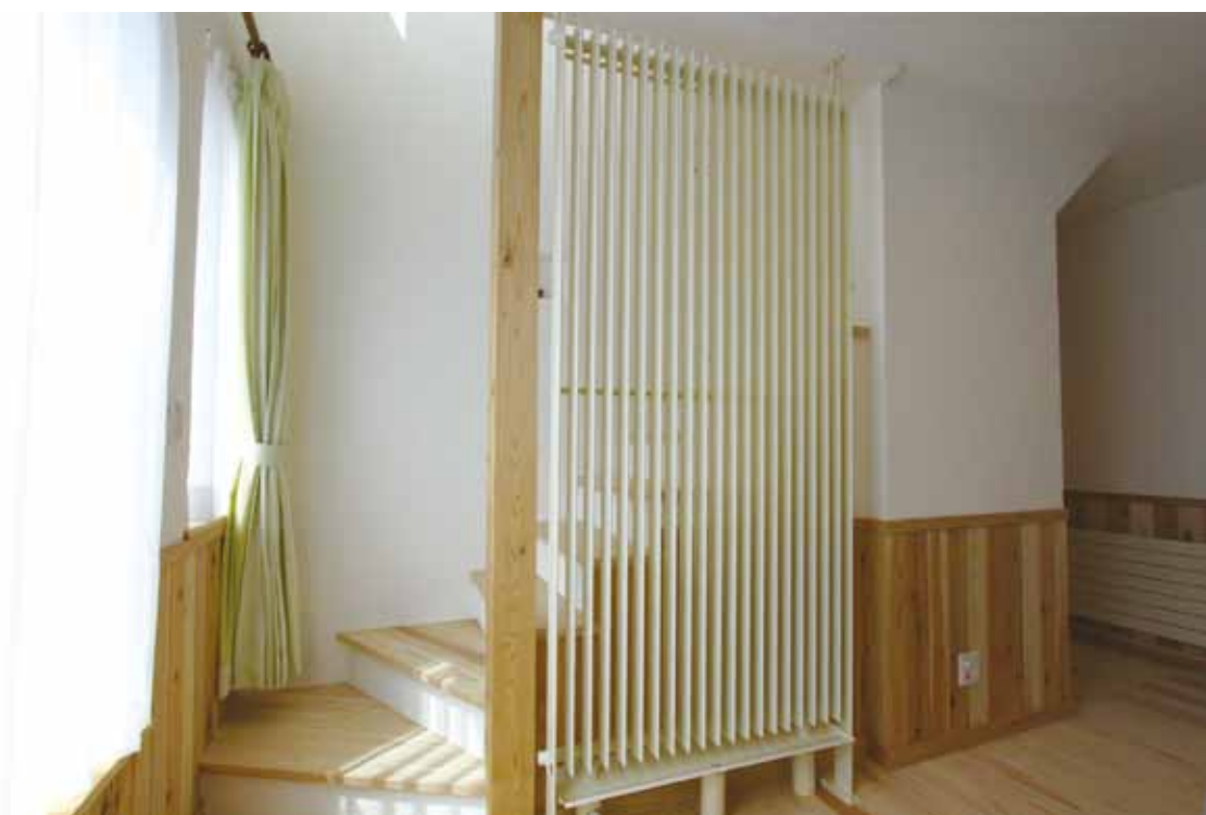
1年を通じて室内を快適な温度に保つ高効率の冷暖房装置
