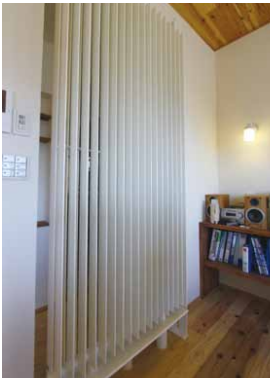
部屋のデザインに溶け込んでいる最新式の冷暖房装置
