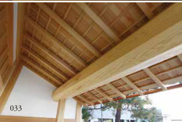
2018年に完成した東京・深川の臨濟宗円覚寺慧然寺に完成した「庫裡・書院」。反り屋根の破風や玄関前の下屋の桁に南部赤松が使われている
