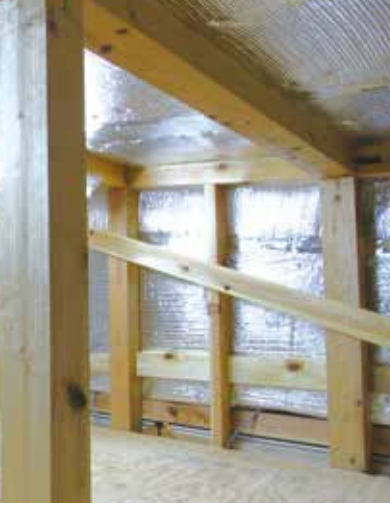
屋根裏に張られている遮熱シートは、宇宙船や宇宙服の反射絶縁材として開発されたもの
