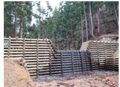
間伐材を用いた木製谷止工を設置し、堆積土砂流出を抑止
