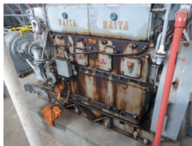
老朽化した機械設備
