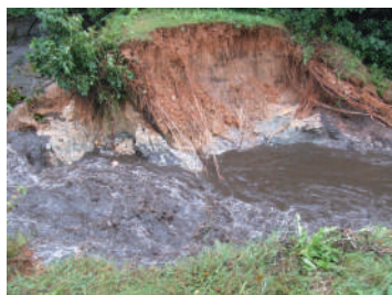
決壊したため池
