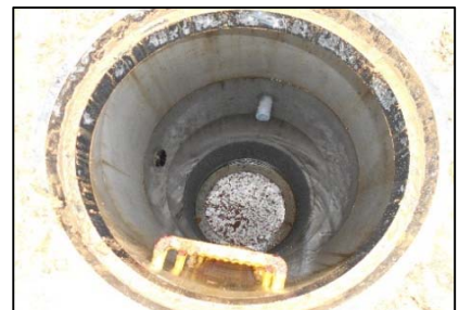
マンホール下部から、透水層へ浸透
