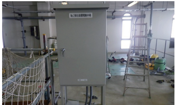
電動弁箱の更新 ほくぶ おいらせ町北部地区（おいらせ町）
