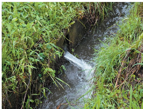
「田んぼダム」未実施 流出量が多い (令和4年8月9日 蓬田村)
