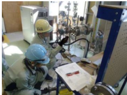
グループ企業の訓練施設での計器類の点検研修
