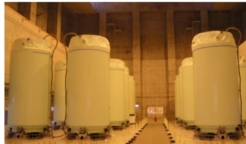
東海第二発電所の乾式貯蔵施設
