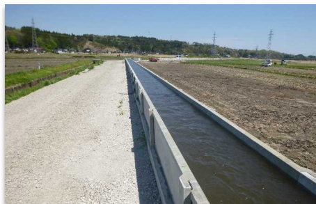
農業水路等長寿命化・防災減災事業 下長西部地区（八戸市、H30～R2） 農業用水路の改修
