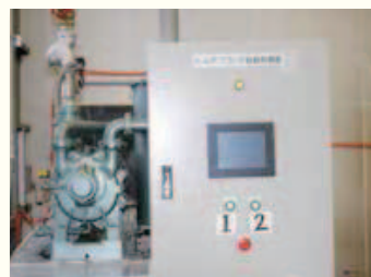
真空ポンプ用制御盤
