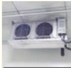
高効率冷凍機（5.5kw タイプ）
