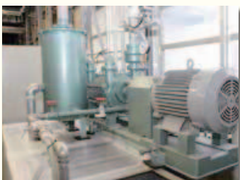
高圧殺菌釜に連結されている真空ポンプ
