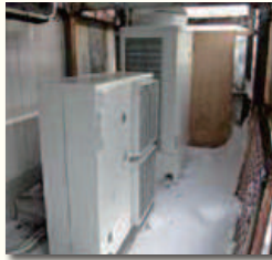
高効率冷凍機（室外機）
