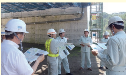
三陸沿岸道路(野田久慈道路)普代久慈工区の現場を視察
